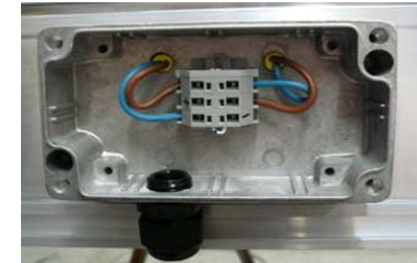
Abb.2: Modulanschlussdose am Kollektor (hier 2 Module)
